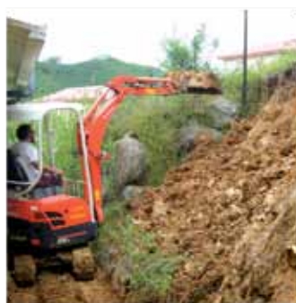
Vaurioitunut luiska rankkasateen jälkeen. Kunnostamistyö edellyttää Rockmat - maton asentamista.
