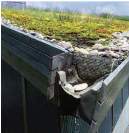
Vedenvälumän viivyttäminen ekstensiivisellä viherkatolla.
